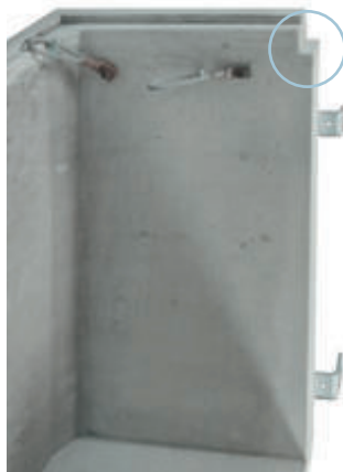
Ausklüftung am Lichtschacht.
