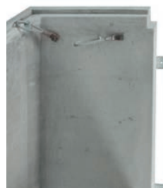
Ausklüpfung am Lichtschacht.
