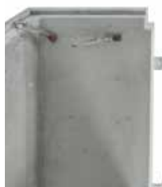
Ausklinkung am Lichtschacht.
