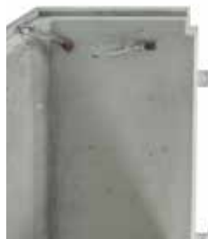
Ausklüftung am Lichtschacht.
